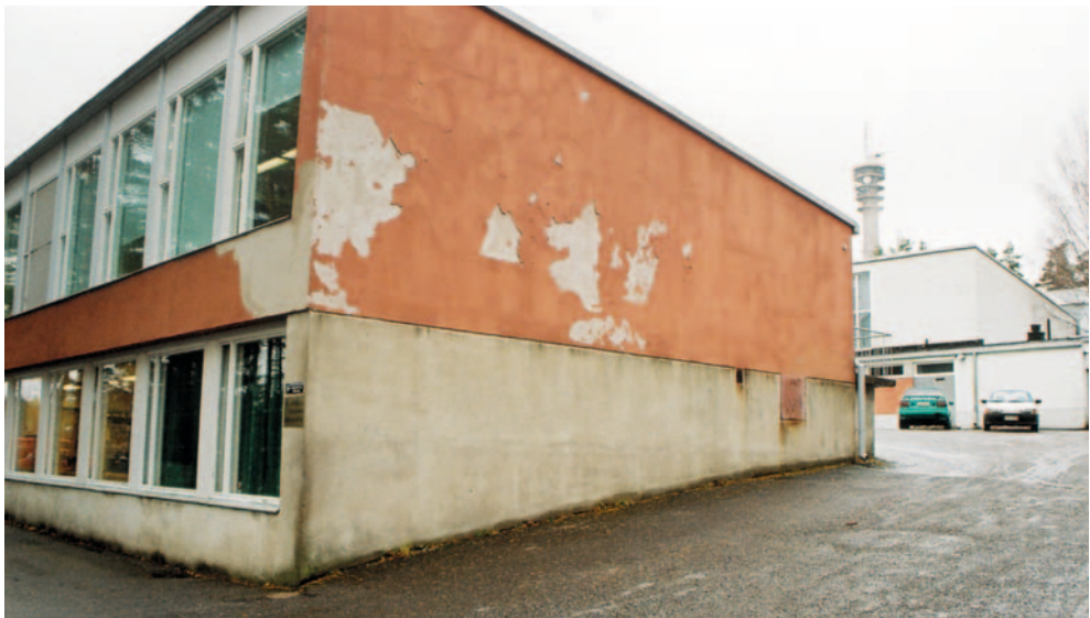
Pääskytuuren koulun ulkoseinätkin alkoivat paljastaa home- ja vesivaurioita ennen kuin koko koulun remontti saatiin käyntiin. Kuva lokakuulta 2002, Kulmakunta.
